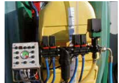
Armatur und Steuerkasten (Botrytis)
